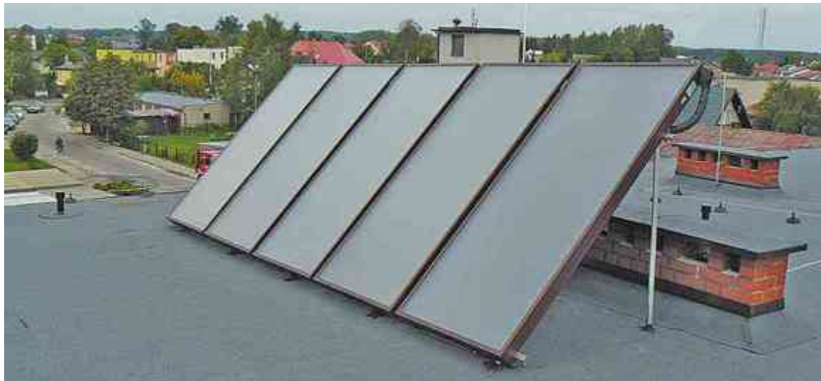
Kolektor słoneczny na dachu budynku Urzędu Gminy. Zbiornik podgrzewacza ciepłej wody o pojemności 650l zlokalizowany jest w piwnicy budynku.
