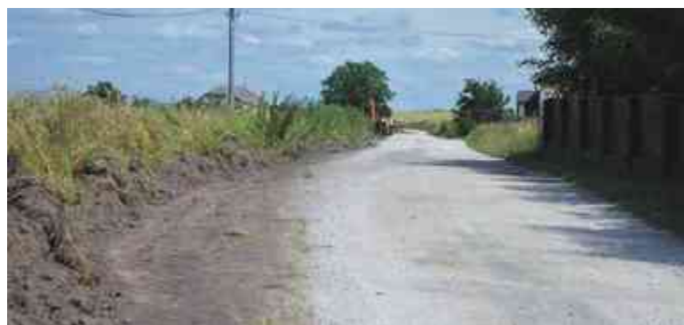
Droga Łączonek – Ostrowite
