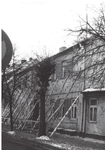
Rozpadający się budynek Przychodni Obwodowej w Rypinie (fot. ok. 1980)
